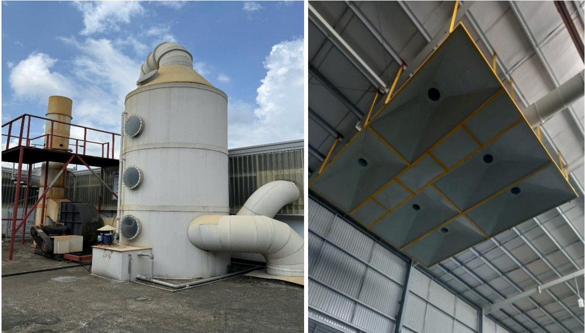
Hình 3.11. Hệ thống xử lý khí thải tiền xử lý bề mặt công suất 32.000 m 3 /h
